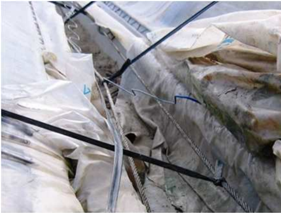
湿気がたまりやすくサビが発生しやすい状況
