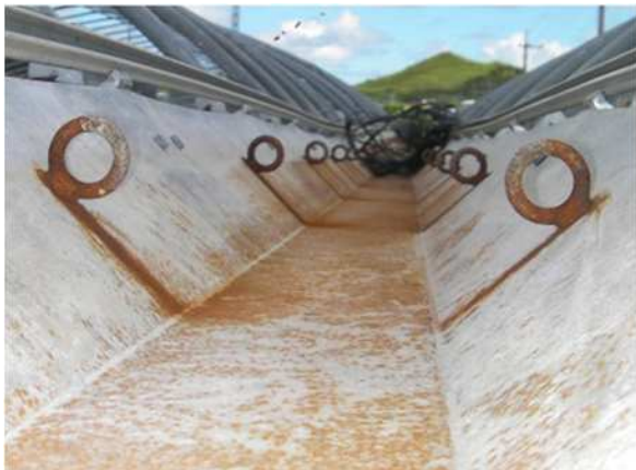
谷どいのサビ(メッキの劣化)
