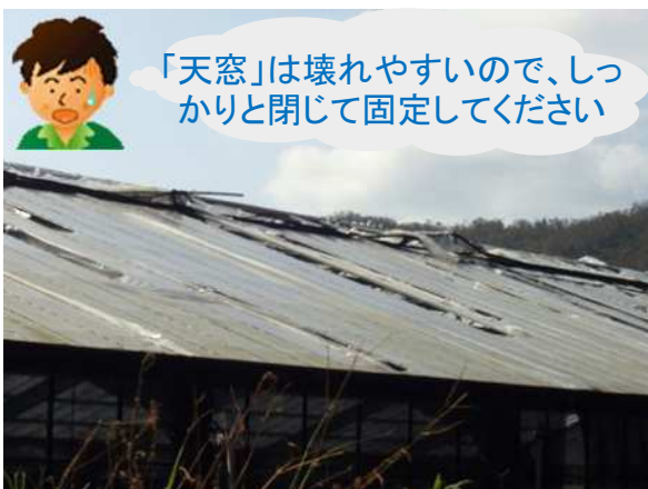
天窗の破壊(石垣市)
