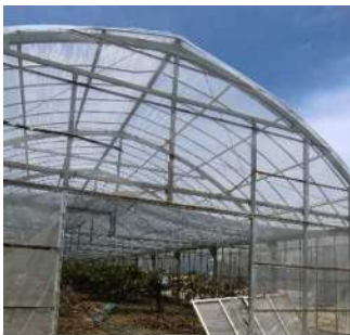
ハウスの出入口、天窓、谷間換気部の被害が大きい。
