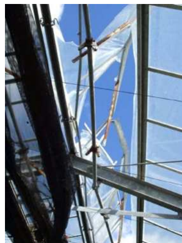
天窗の破壊(豊見城市)
