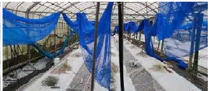
内張ネットが強風で外れ被害を受けた事例
